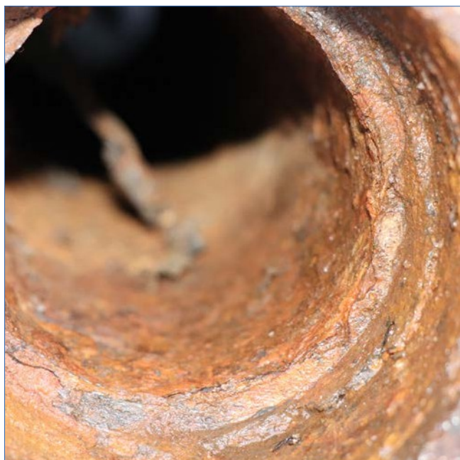
Starý a poškodený odtok.
